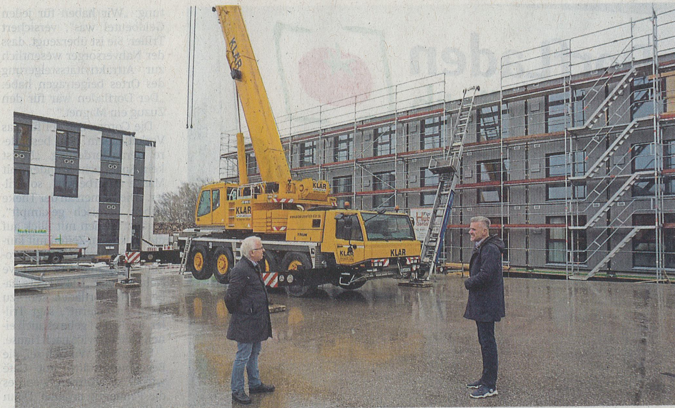
Ein Campus im Bau: Robert Decker (r.) zeigt Vize-Bürgermeister Ludwig Rudolf das derzeit entstehende Studentenwohnheim. Links ist das Lehrgebäude zu sehen. Ein weiteres will Decker bis September errichten.
